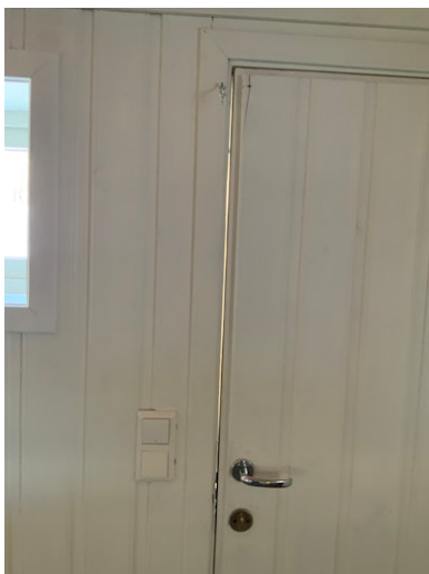
Luftspalt på ytterdør
