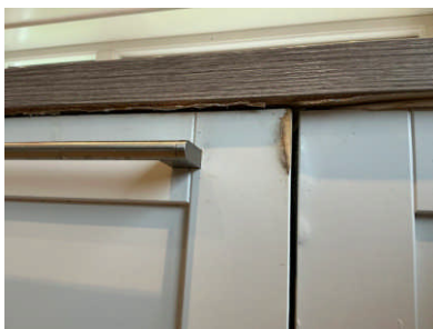
Fuktskader i front av oppvaskmaskin og i benkeplate over oppvaskmaskin.
