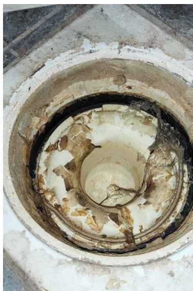
Avløpsrør (ink. sluk) - [Sluk bad]
