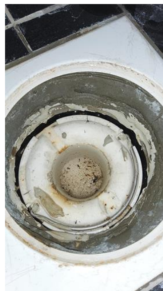
Avløpsrør (ink. sluk) - [Sluk vaskerom]
