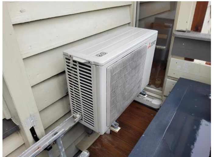
Tekniske anlegg, VVS anlegg (Sjekkpunkter utover det som er inkludert i andre rom) - [Varmepumpe ]
