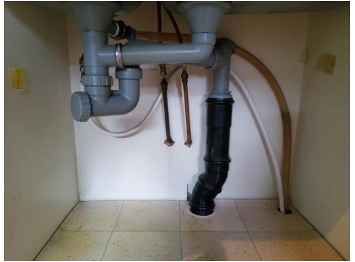
Tekniske anlegg, VVS anlegg (Sjekkpunkter utover det som er inkludert i andre rom) - [Rørøpplegg i benkeskap hybel ]
