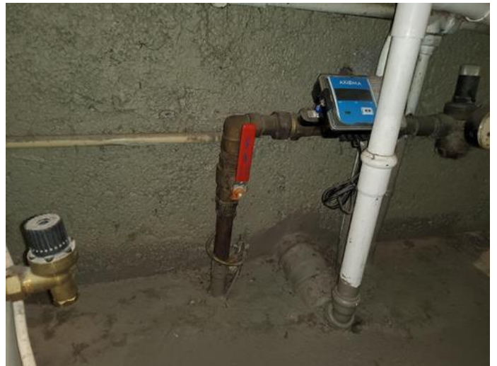
Tekniske anlegg, VVS anlegg (Sjekkpunkter utover det som er inkludert i andre rom) - [Hovedstoppekran og vanninntaksrør ]
