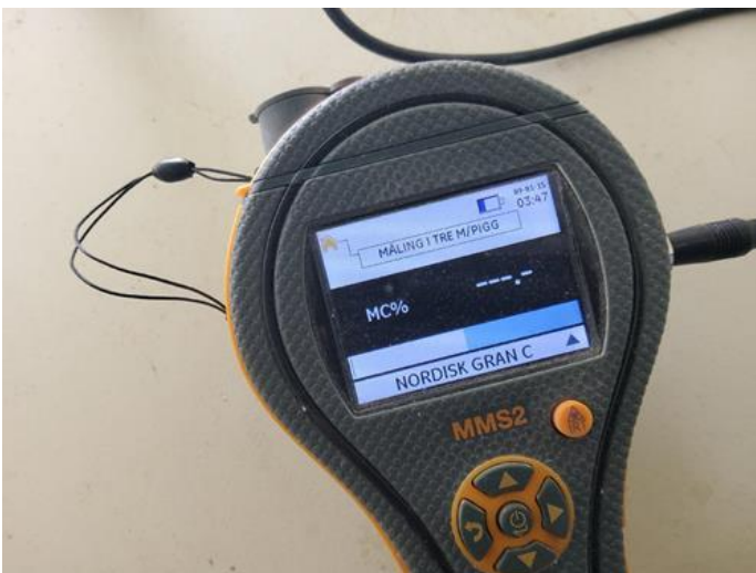
Fukt i tilliggende konstruksjoner - [Fuktmåling]
