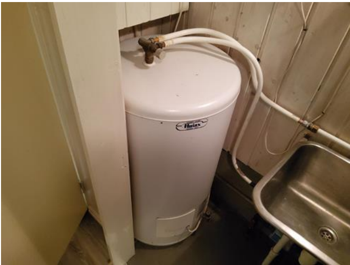
Tekniske anlegg, VVS anlegg (Sjekkpunkter utover det som er inkludert i andre rom) - [Varmtvannsbereder ]
