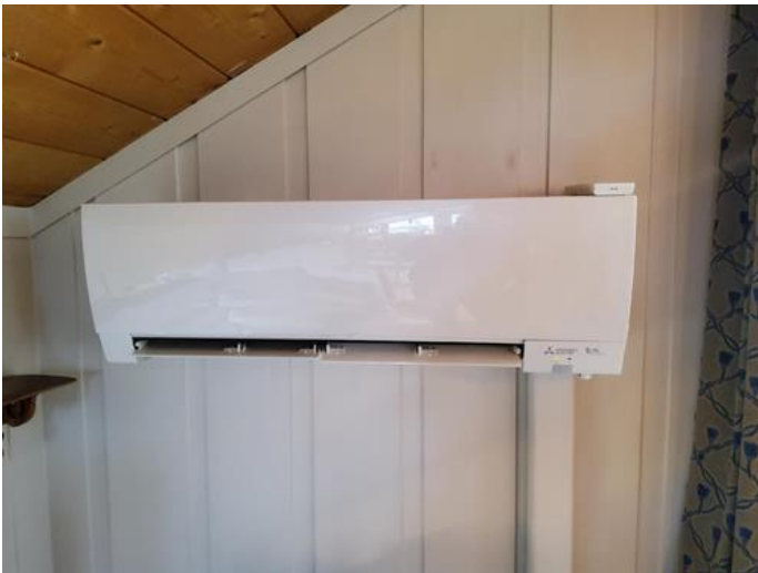
Tekniske anlegg, VVS anlegg (Sjekkpunkter utover det som er inkludert i andre rom) - [Varmepumpe ]
