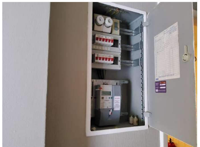
Elektrisk anlegg - [Sikringskap i hybel ]
