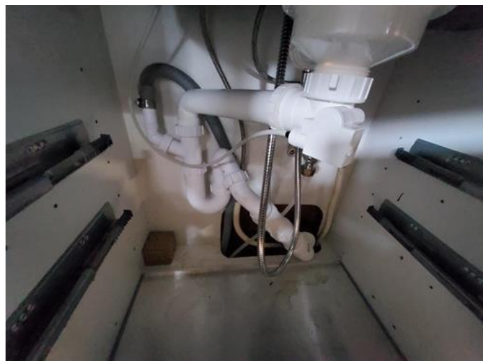
Tekniske anlegg, VVS anlegg (Sjekkpunkter utover det som er inkludert i andre rom) - [Rørpropplegg i benkeskap ]
