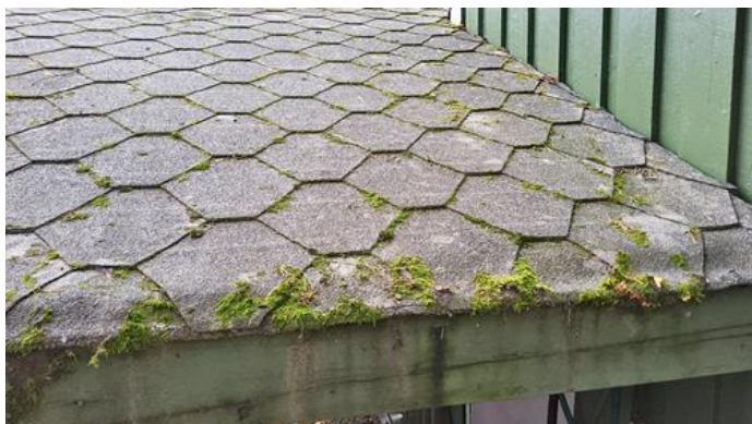
Helhetsvurdering - [Råteskader på tak over carport]
