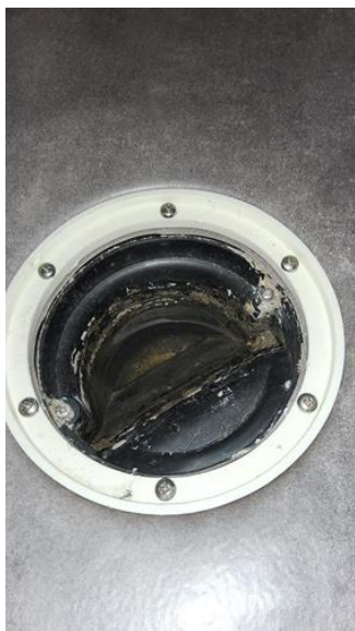
Avløpsrør (ink. sluk) - [Sluk bad kjeller]
