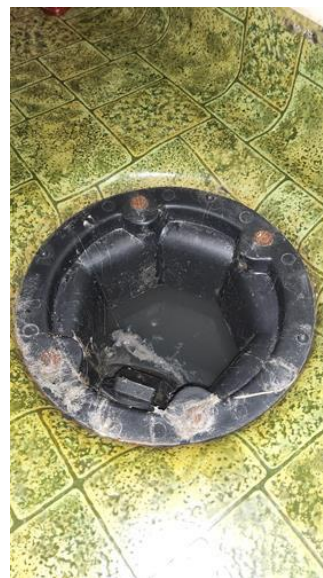
Helhetsvurdering - [Sluk bad 1. etasje]
