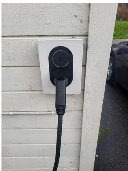
Elektrisk anlegg - [Elbillader]
