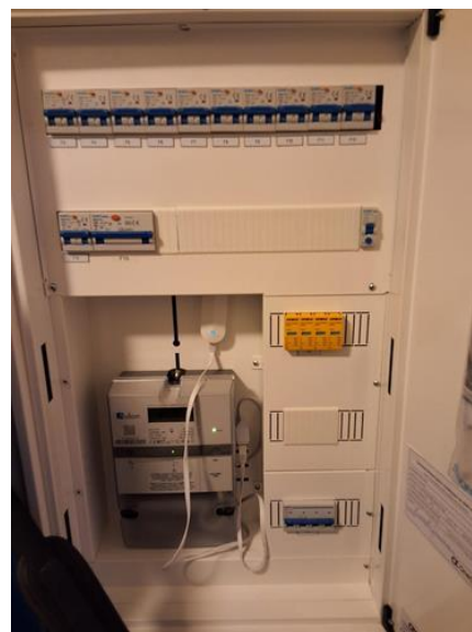
Elektrisk anlegg - [Sikringskap]
