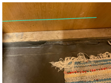
Sprekk i belegg ved oppkant mot dørkarm
