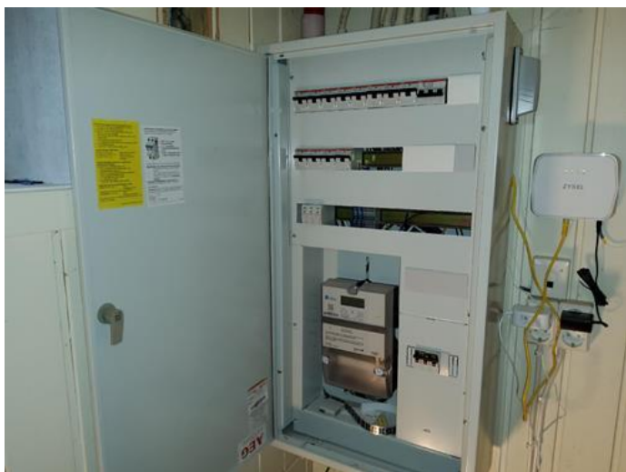
Elektrisk anlegg - [Sikringsskap. ]
