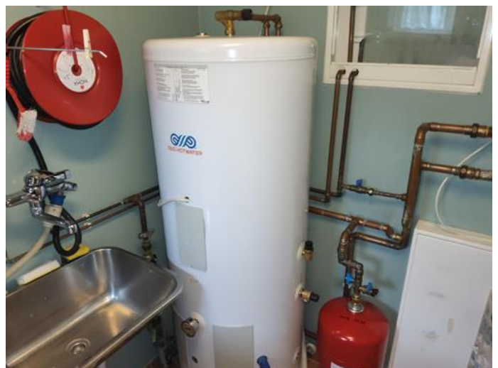
Tekniske anlegg, VVS anlegg (Sjekkpunkter utover det som er inkludert i andre rom) - [Varmtvannsbereder, utslagsvask og brannslange ]
