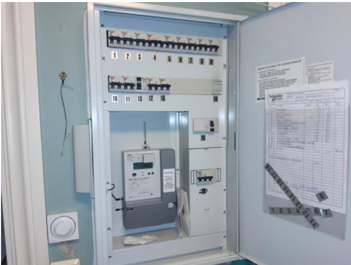
Elektrisk anlegg - [Sikringskap ]
