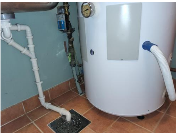
Tekniske anlegg, VVS anlegg (Sjekkpunkter utover det som er inkludert i andre rom) - [Vanninntaksrør, stoppekran og vannmåler ]
