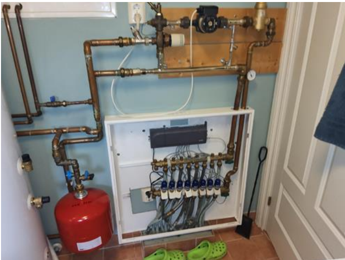
Tekniske anlegg, VVS anlegg (Sjekkpunkter utover det som er inkludert i andre rom) - [Fordelerskap for vannbåren gulvvarme, ekspansjonstank og pumpe]
