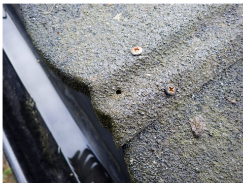
Sannsynligvis hull etter skruer
