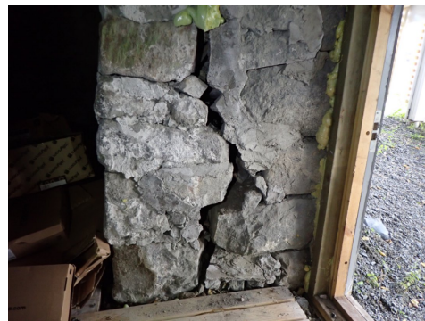
"Intern" sprekk i eldste mur
