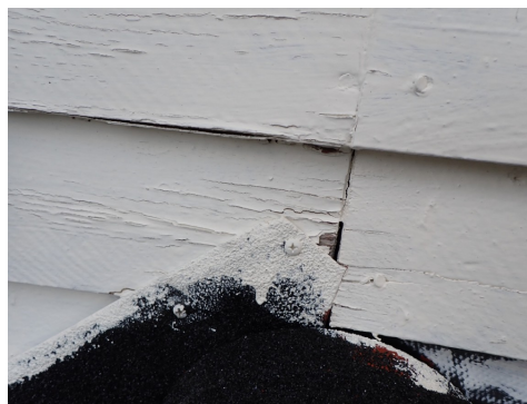
Feil utført beslag (ligger utenpå bordkledning)
