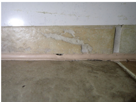
Glipper i fuging gulv/sokkelflis, manglende åpning sokkelflis/veggplate
