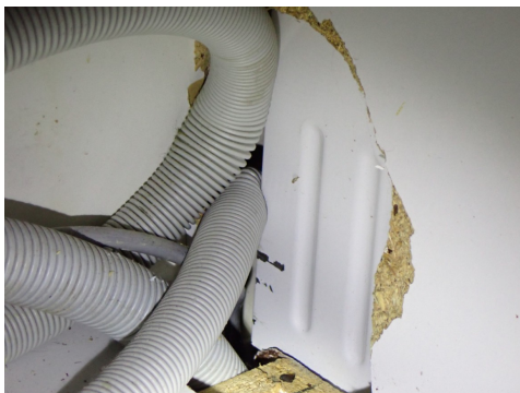
Rør ligger slik at oppvaskmaskin ikke kan skyves helt inn
