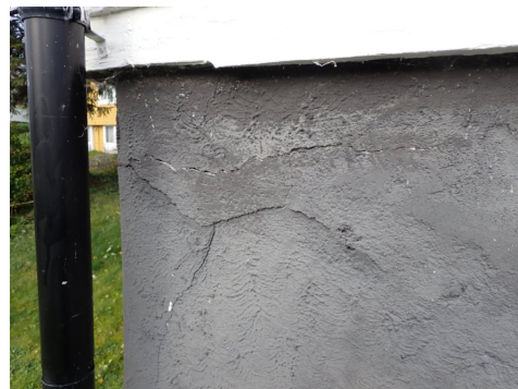
Sprekker ved hjørne mot vest, synlig inn- og utvendig
