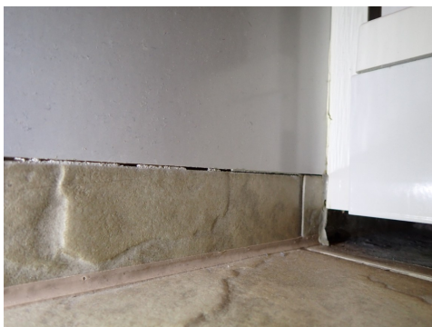
Fuging med uegnet masse, stedvis mangler
