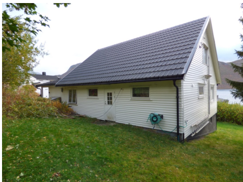
Nedbøyning i takrenne (ca midt på, ved dør)
