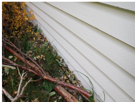
Kledning mot nord ligger stedvis helt ned til bakken
