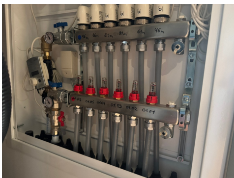
Rørskap i boden til det vannbårne anlegget.
