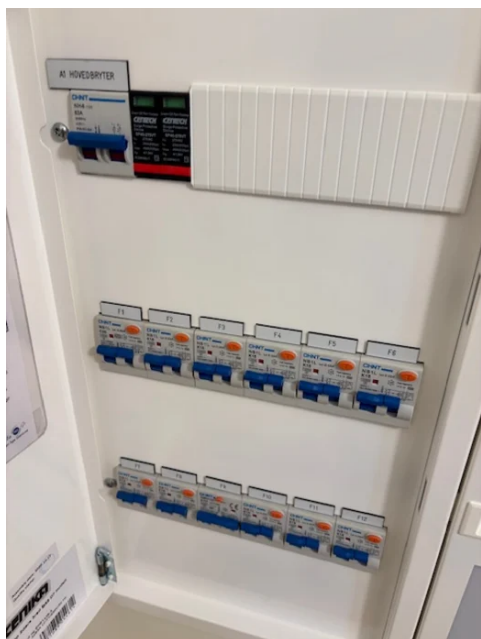
Sikringskap med automatsikringer plassert i bod.
