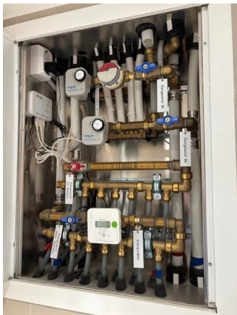
Rørfordelerskap til vannbåren varme plassert i bad/vaskerom2. I samme skap er det bl.a. vannmåler og stoppekran.
