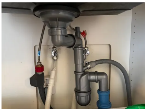
Avløpsrør i underskap vask på kjøkkenet.
