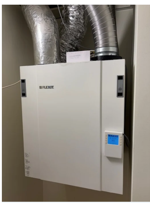
Ventilasjonsaggregat plassert i bod.
