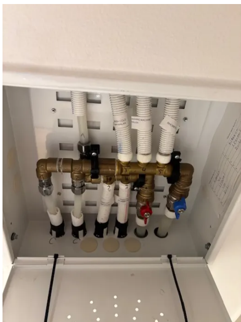
Rørfordelerskap plassert i himling på bad/vaskerom1 over dusjsone.
