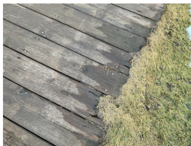
Tilløp til råte i terrassebord.
