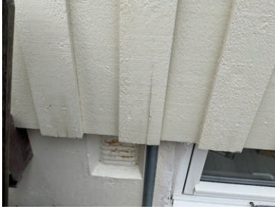
Sprekk i bordkledning.
