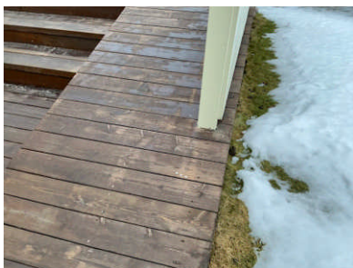
Slitte overflater på terrasse.
