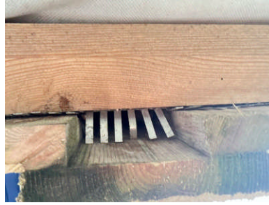
Stedvis musesperre ved kontroll rundt bolig.
