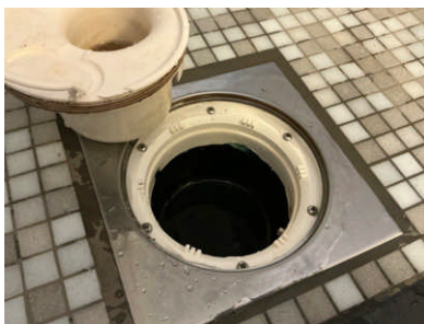
Sluk i dusjsone.
