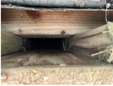
Stedvis manglende musesperre ved kontroll rundt bolig.
