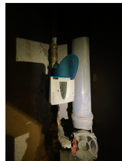
Vannmåler og stoppekrane i vegg trapperom kjeller.
