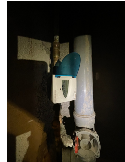
Vannmåler og stoppekrane i vegg trapperom kjeller.
