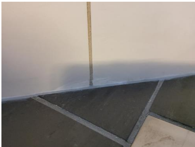
Kommentar - [Sprekker i veggfliser i dusjsonen bad 2.etg. ]
