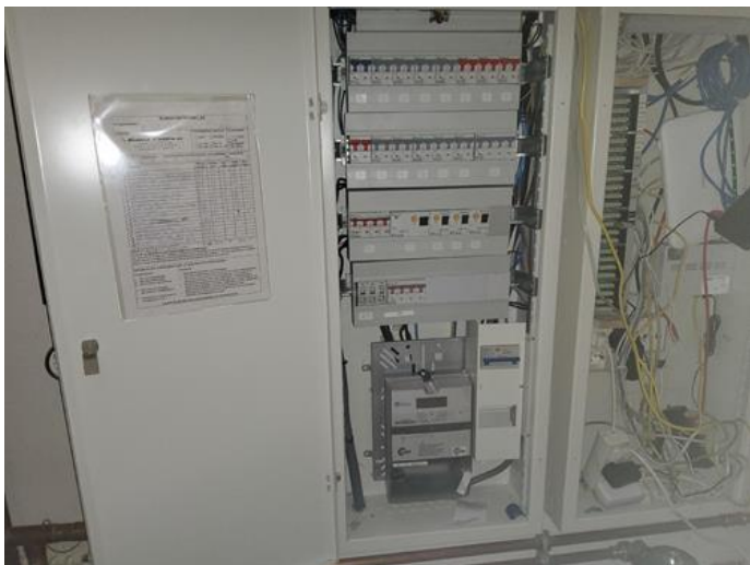
Kommentar - [Sikringsskap plassert i teknisk rom. ]
