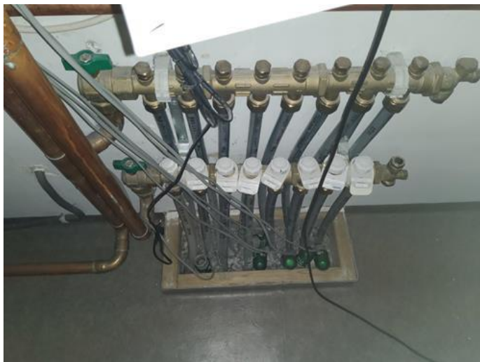
Kommentar - [Fordelerstammer til vannbåren varme til leiligheter (ikke koblet).]
