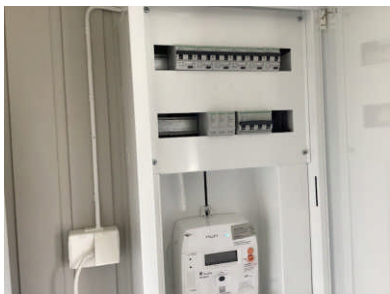
Bilde av sikringskap
