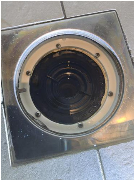
Sluket tilkomstmulighet for rengjøring - [Sluket i dusjsonen. Bad i kjeller ]
