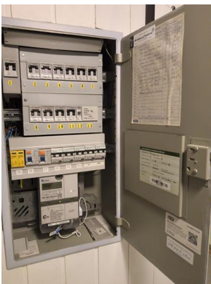
Elektrisk anlegg - [Sikringskap ]
