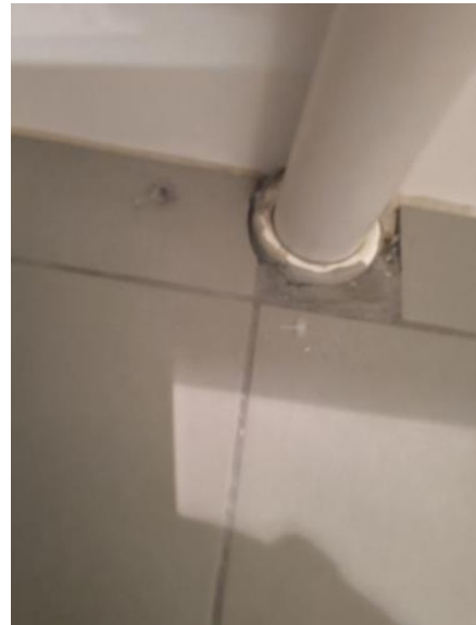
Membran, tettesjikt og overgang til sluk. - [Tettedetaljer rundt avløpsrør. Bad i kjeller ]
