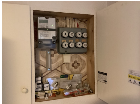
Bilde av sikringer.
