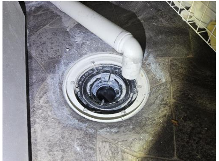
Våtrom - [Sluk på vaskerom. ]
