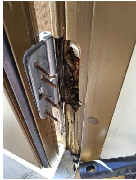
Dører og vinduer - [Råteskader på dørkarm til utvendig bod.]
