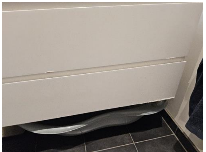
Våtrom - [Mindre fuktskader på servantinredning. ]
