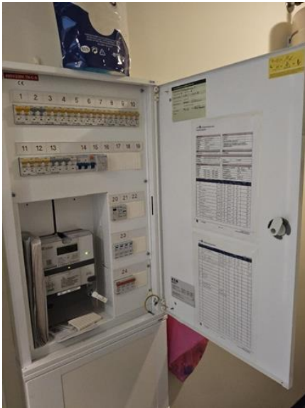
Elektrisk anlegg - [Sikringskap. ]
