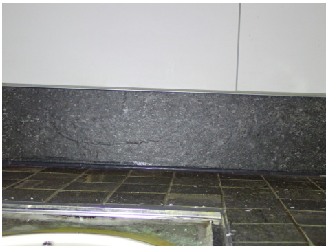
Liten/ingen åpning mellom bunnlist/sokkelflis
