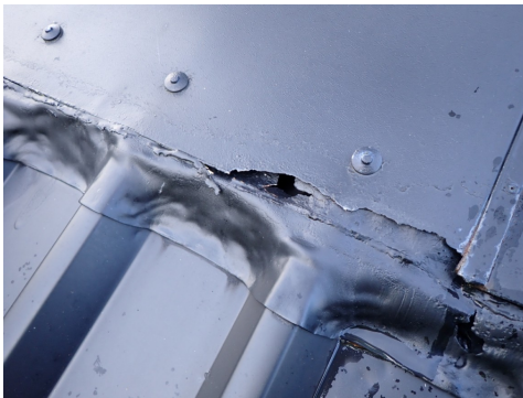
Rust i pipebeslag
