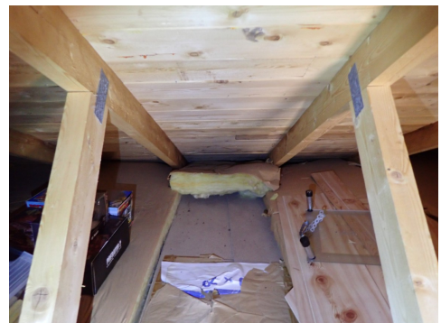
Manglende/dårlig lufting ved raft
