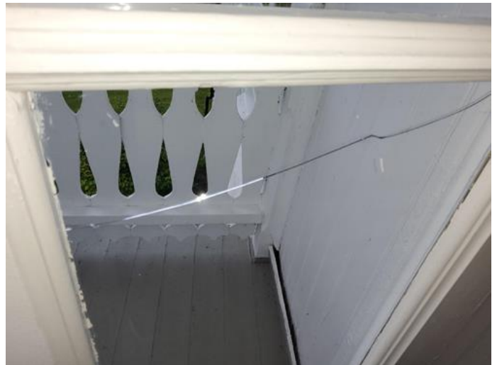
Dører og vinduer - [Sprukket glass balkongdør]
