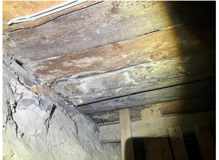
Rom under terreng (kjeller, underetasje, sokkeletasje) - [Eksempel på soppdannelser i kjeller]
