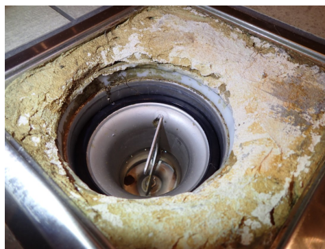
Sluk på bad/vaskerom
