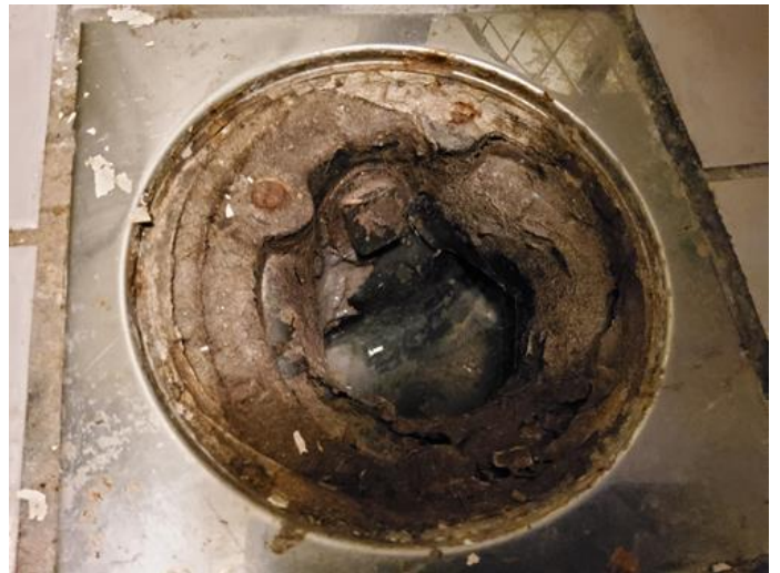
Avløpsrør (ink. sluk) - [Sluk i vaskerom.]
