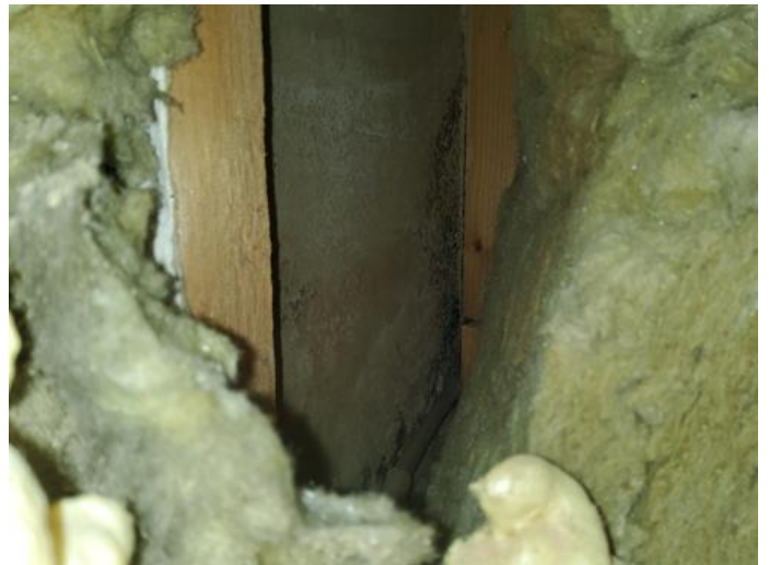
Kommentar - [Svertesopp i sjakter på baksiden av bad.]
