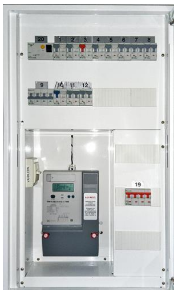
Forenklet vurdering av det elektriske anlegget - [Sikringsskap]
