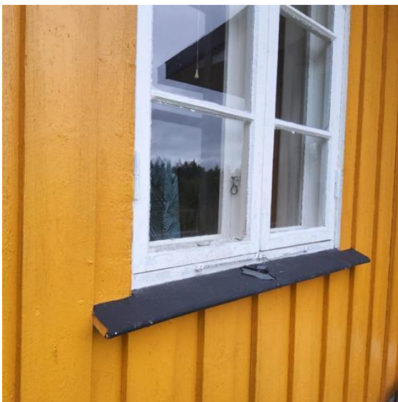
Utvendig - [Eksempel på slitasjer]
