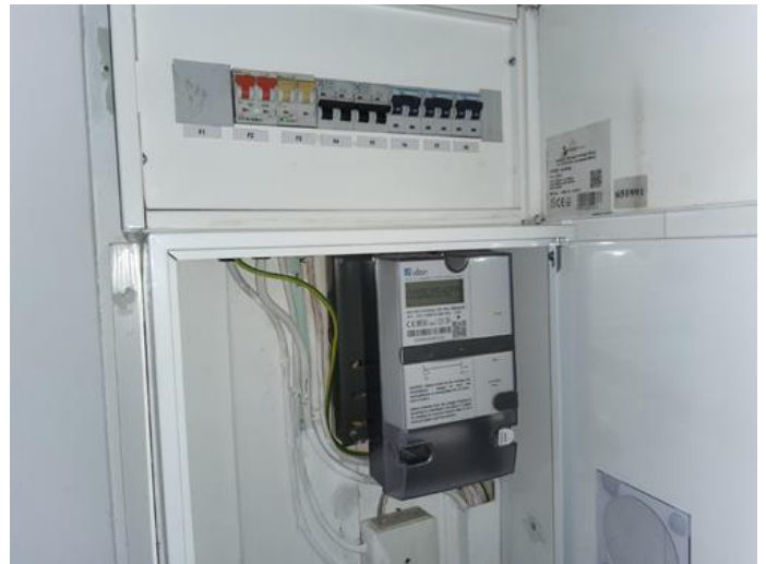
Elektrisk anlegg - [Sikkeringskap plassert i trapp til loftetasje.]
