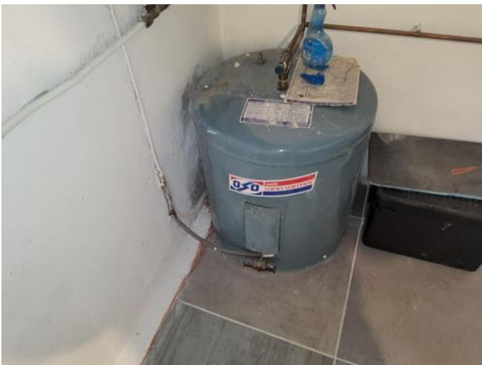
Tekniske anlegg, VVS anlegg (Sjekkpunkter utover det som er inkludert i andre rom) - [Varmtvannsbereider plassert i vaskerom.]
