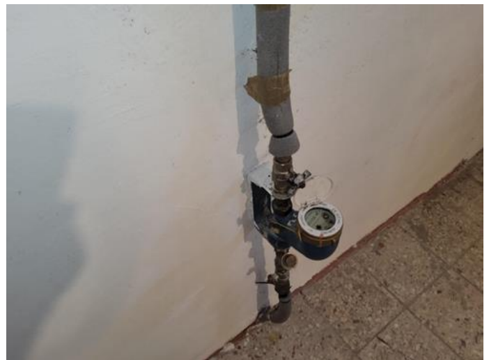
Tekniske anlegg, VVS anlegg (Sjekkpunkter utover det som er inkludert i andre rom) - [Hovedstoppekran plassert i kjeller.]
