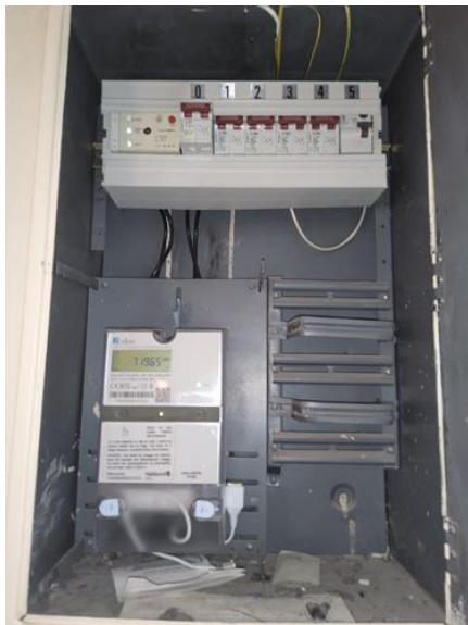
Elektrisk anlegg - [Sikringsskap]
