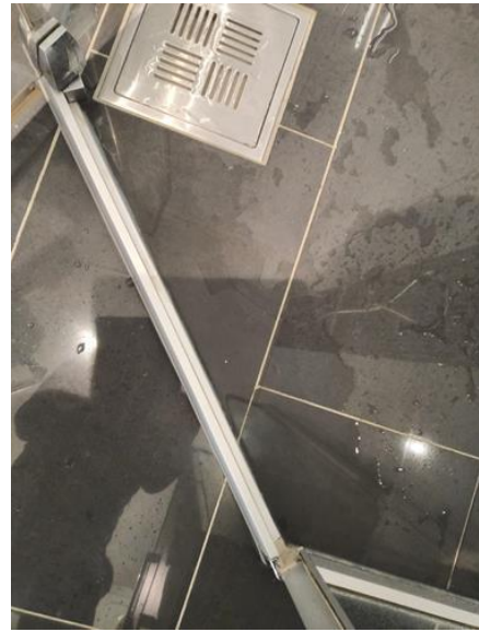
Fallforhold (gulv) - [Fallforholdet i dusjsonen ]
