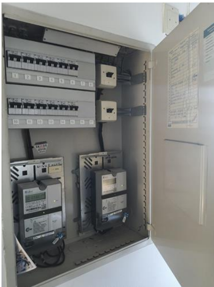
Elektrisk anlegg - [Sikringskap ]
