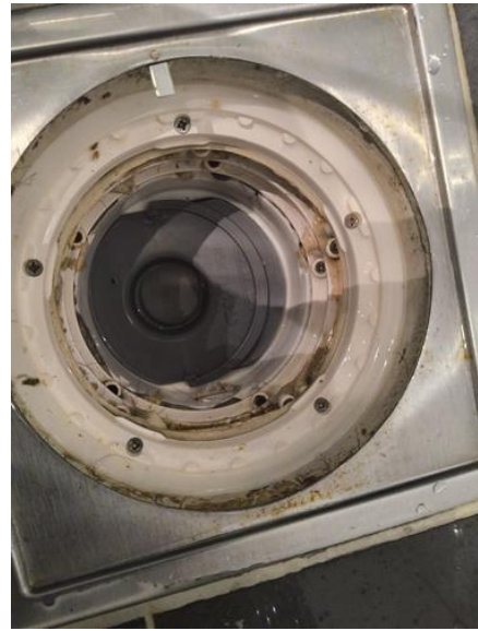
Slukets tilkomstmulighet for rengjøring - [Sluket i dusjsonen ]
