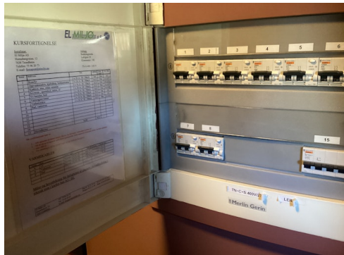
Bilde av sikringskap
