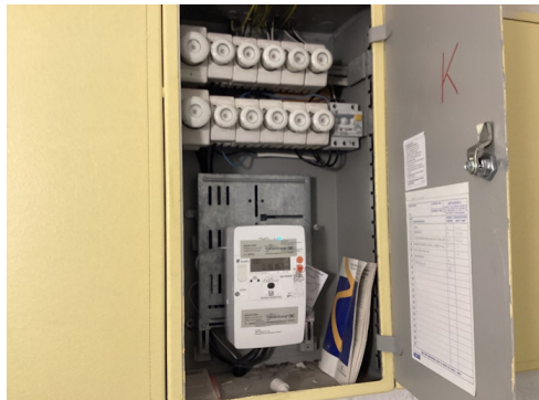
Bilde av sikringskap
