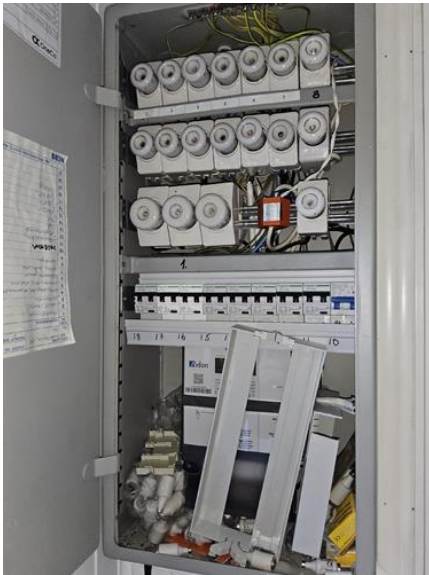
Elektrisk anlegg - [Sikringsskap]
