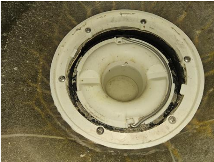
Avløpsrør (ink. sluk) - [Sluk, bad]
