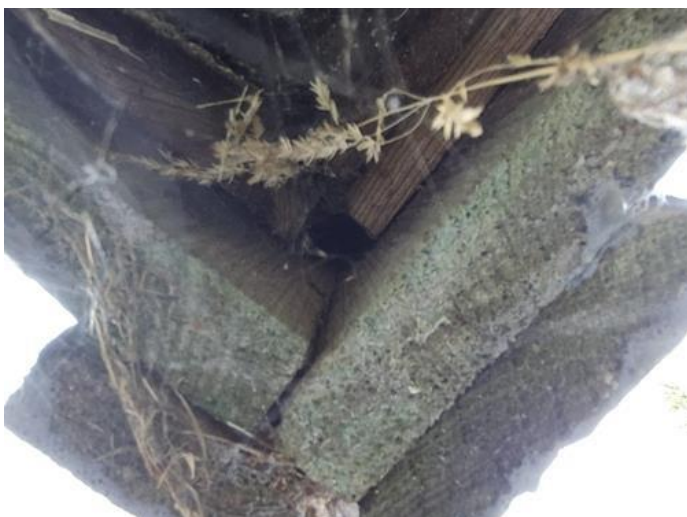
Yttervegger inkl. fasader og konstruksjon - [Manglende musesperre]
