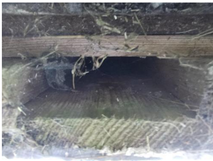
Yttervegger inkl. fasader og konstruksjon - [Manglende musesperre]
