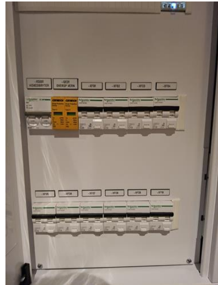
Elektrisk anlegg - [Sikringsskap.]
