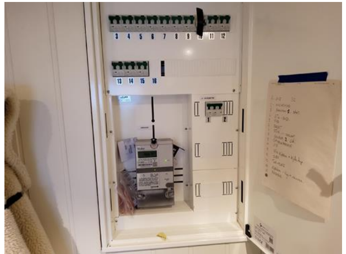
Elektrisk anlegg - [Sikringsskap kjeller.]
