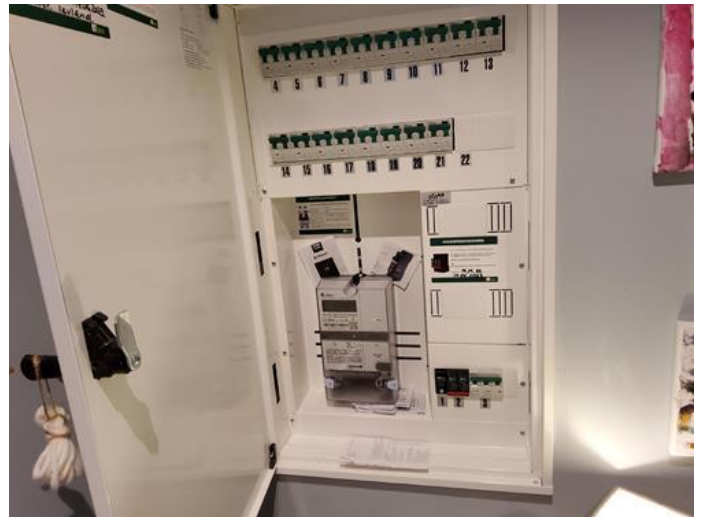
Elektrisk anlegg - [Sikringsskap 1. etg.]
