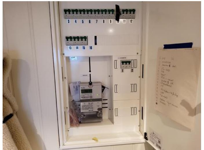
Elektrisk anlegg - [Sikringsskap kjeller.]
