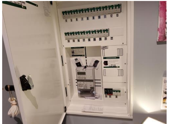
Elektrisk anlegg - [Sikringsskap 1. etg.]
