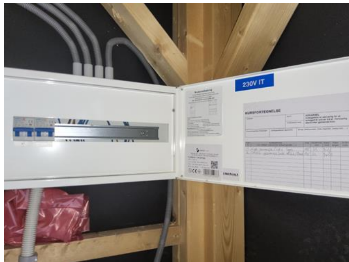
Beskrivelse - [Sikringsskap i garasje]
