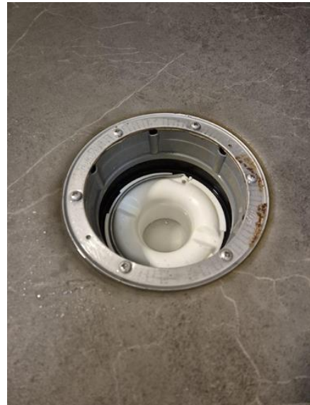
Avløpsrør (ink. sluk) - [Sluk Bad 1. etasje]
