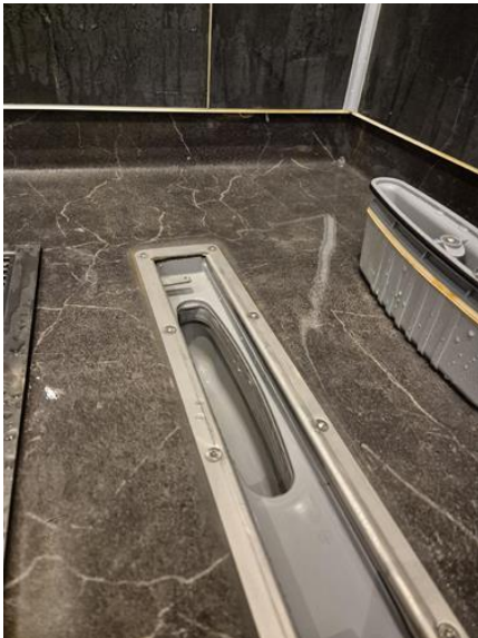
Avløpsrør (ink. sluk) - [Sluk Bad 2. etasje]
