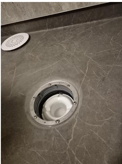
Avløpsrør (ink. sluk) - [Sluk bad leilighet]
