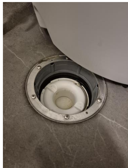
Overflater gulv - [Sluk teknisk rom]
