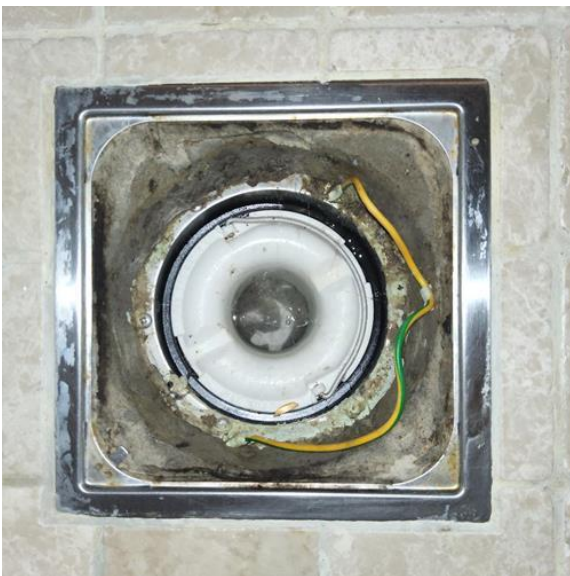
Avløpsrør (ink. sluk) - [Sluk bad kjeller]
