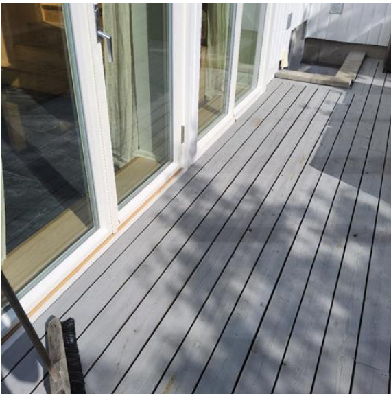
Utvendig - [Liten differanse/høydeforskjell mellom utvendig gulv og dørterskel]
