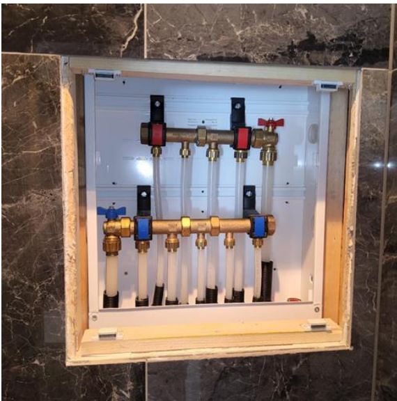
Tekniske anlegg, VVS anlegg (Sjekkpunkter utover det som er inkludert i andre rom) - [Fordelerskap for rør-i-rør system plassert i toalettrom i bad 1 i 2.etasje ]
