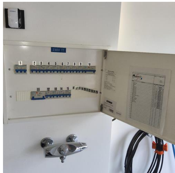
Elektrisk anlegg - [Sikringskap og kursoversikt plassert i garasje]
