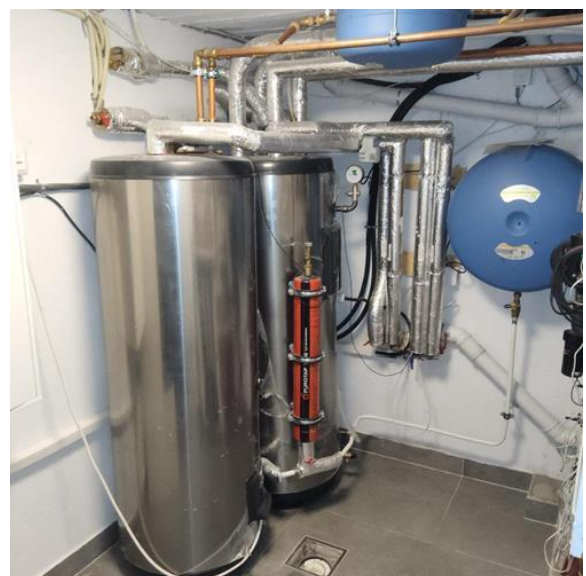
Tekniske anlegg, VVS anlegg (Sjekkpunkter utover det som
