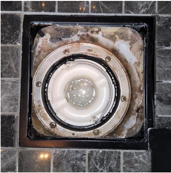
Avløpsrør (ink. sluk) - [Sluk dusjsonen bad 1 i 2.etasje ]
