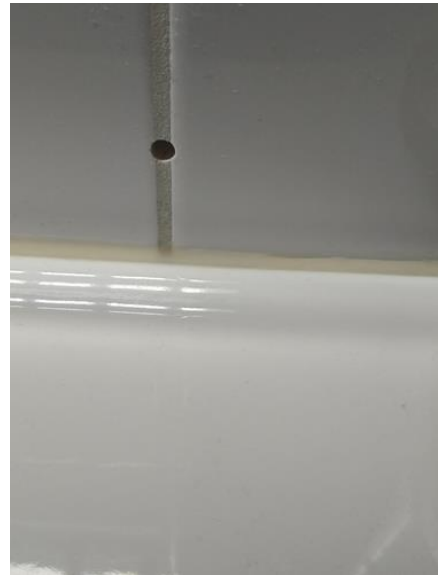
Overflater vegger - [Hull i veggflis ved vask ]
