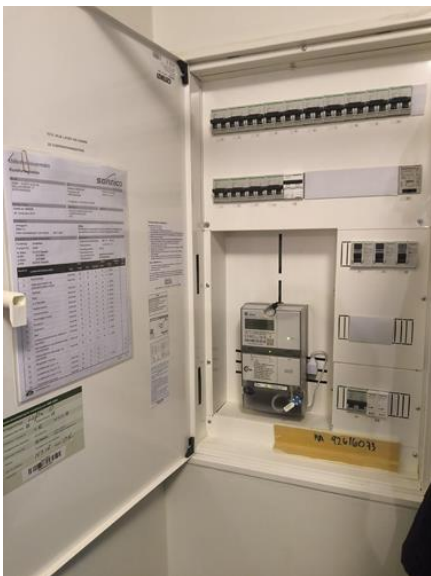
Elektrisk anlegg - [Sikkeringskap ]
