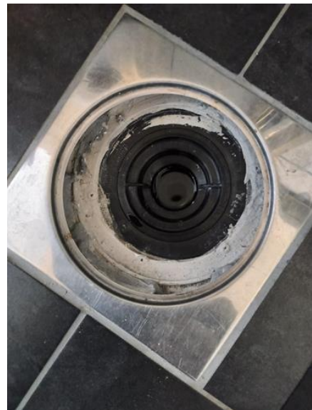
Slukets tilkomstmulighet for rengjøring - [Sluket på vaskerom ]
