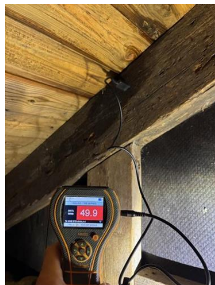
Overflater vegger/undertak - [Forhøyede fuktverdier i undertak.]
