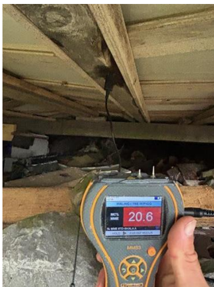
Overflater vegger/undertak - [Forhøyede fuktverdier i stubloft under hytten]
