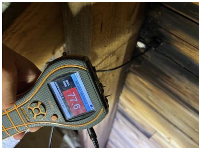
Overflater vegger/undertak - [Forhøyede fuktverdier i undertak.]
