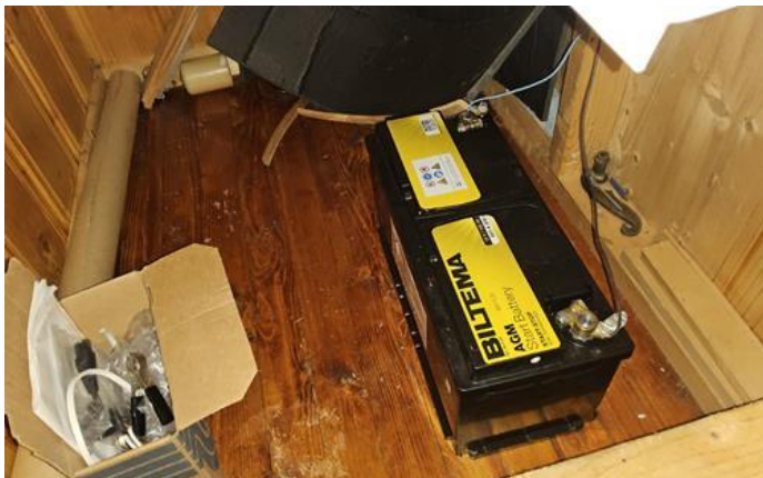
Elektrisk anlegg - [Batteri tilkoblet solcellepanel.]
