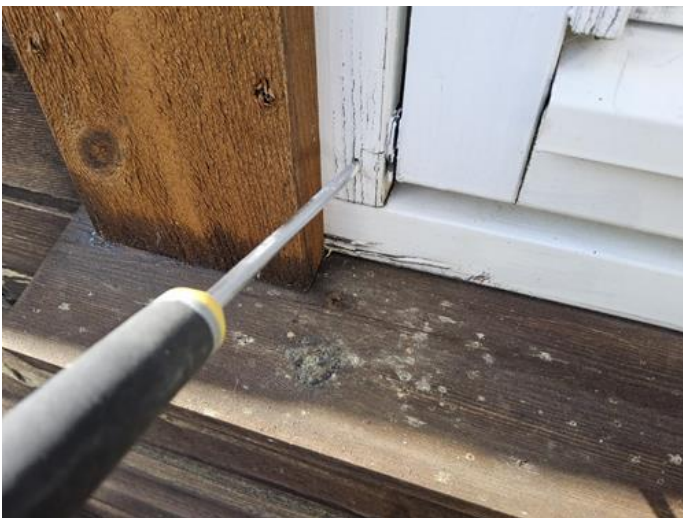
Dører og vinduer - [Råteskader vindu kjøkken. ]
