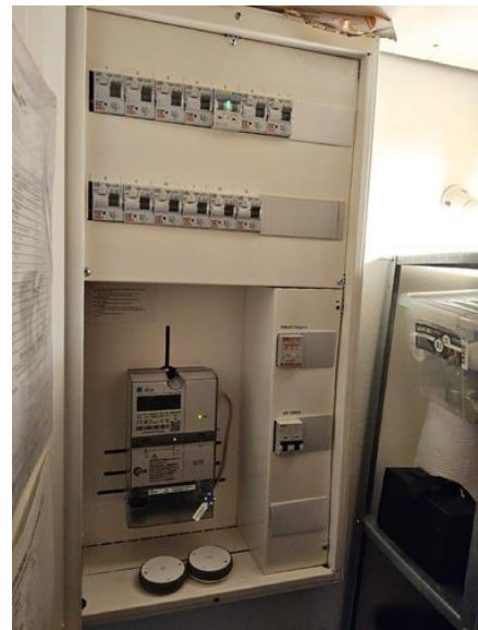
Elektrisk anlegg - [IMG_20250905_145152]
