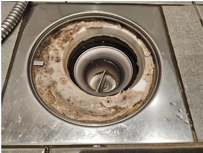
Avløpsrør (ink. sluk) - [Sluk baderom]
