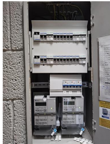
Elektrisk anlegg - [Sikringsskap]
