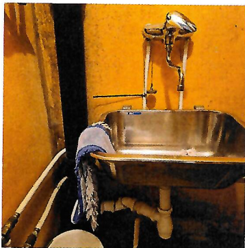
Synleg fukt under vaskekar.
