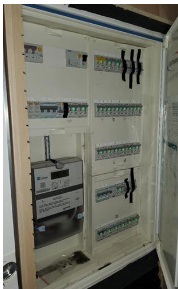
Elektrisk anlegg - [Sikringsskap]
