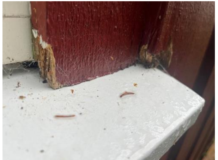
Kommentar - [Eksempel på råteskader]
