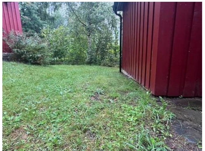
Beskrivelse - [Terrengfall mot grunnmur]
