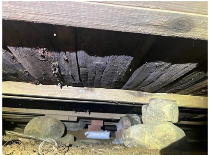
Helhetsvurdering - [Eksempel på råteskader i krypekjeller]
