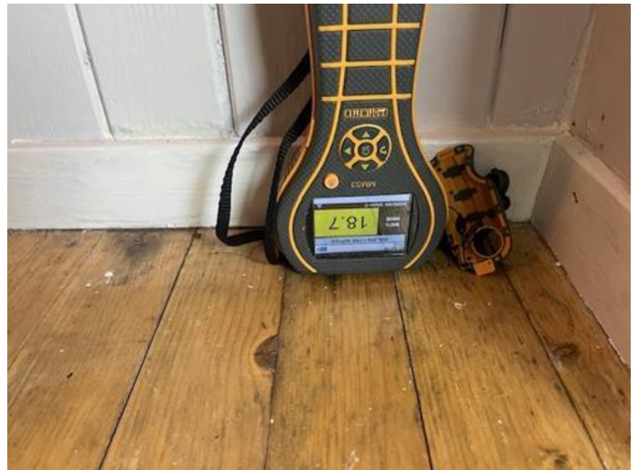
Øvrige rom [eksklusive spesialrom] - [Fuktmåling i entregulv]
