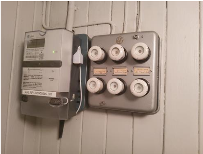
Elektrisk anlegg - [Sikringsskap]
