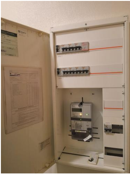
Elektrisk anlegg - [Sikringskap i kjeller ]
