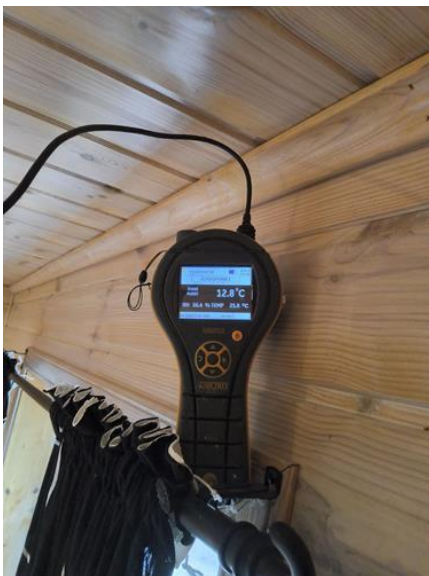
Fukt i tiliggende konstruksjoner - [Fuktmåling vaskerom ]
