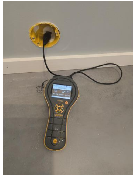
Fukt i tilliggende konstruksjoner - [Fuktmåling bad 2 etasje ]
