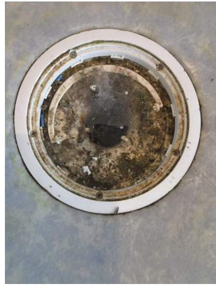
Slukets tilkomstmulighet for rengjøring - [Sluket ved bereder ]
