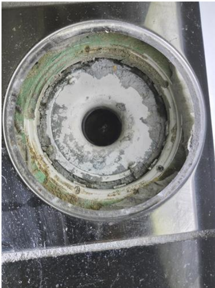
Slukets tilkomstmulighet for rengjøring - [Sluket ved vaskemaskin]
