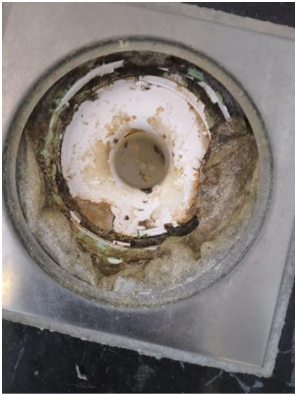
Slukets tilkomstmulighet for rengjøring - [Sluket under dusjkabinett. Bad 2 etasje ]
