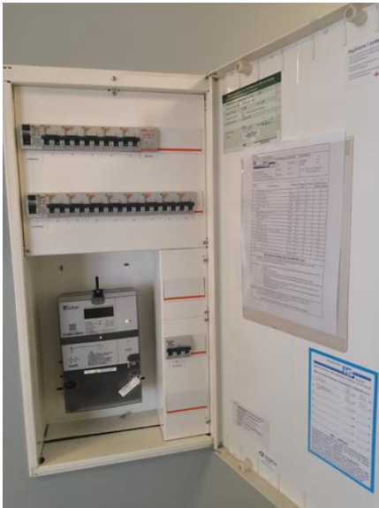
Elektrisk anlegg - [Sikringskap 1 etg ]
