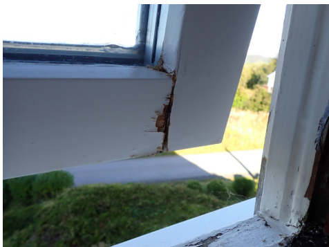
Fuktskader på vindu i stue
