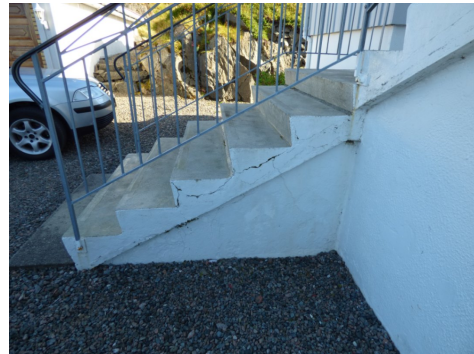
Oppsprekking på siden av trappa
