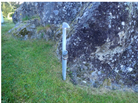
Påfyllingsrør og lufting for nedgravd oljetank
