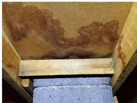
Fuktskjolder ved pipa
