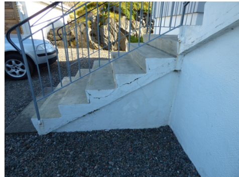
Oppsprekking på siden av trappa
