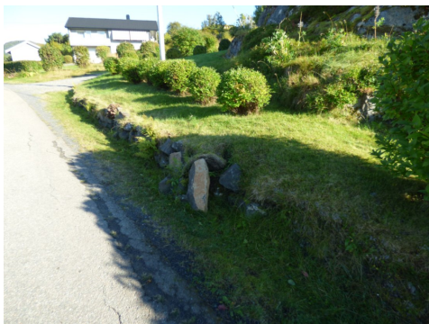
Mur langs vei med mindre skader
