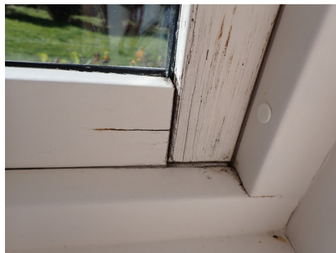
Fuktskader, nedre del av omramming har løsnet
