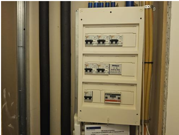
Elektrisk anlegg - [El-skap.]
