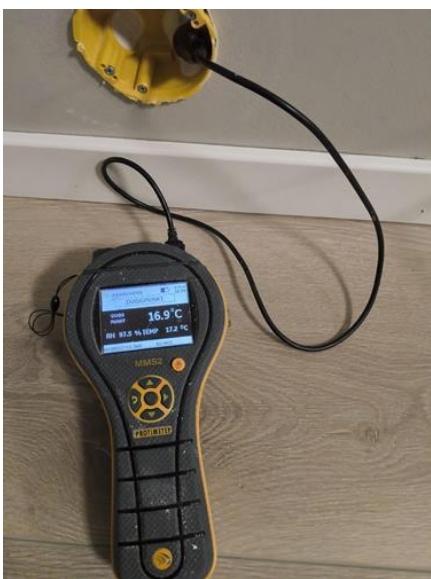
Konstruksjoner (tilfarergulv, himling og vegger). - [Fuktmåling kjellevegg ]
