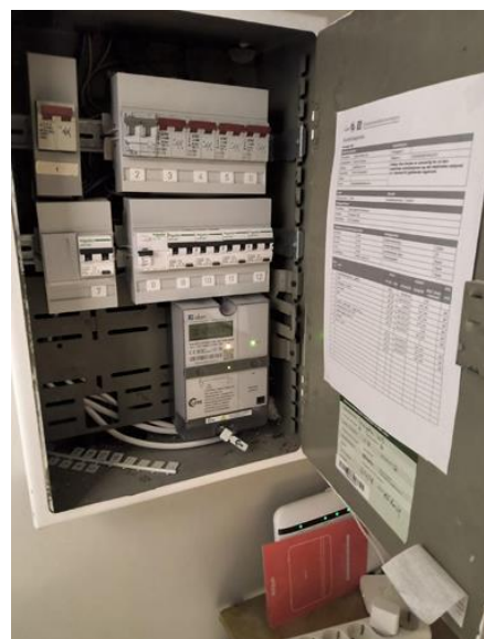
Elektrisk anlegg - [Sikringsskap ]
