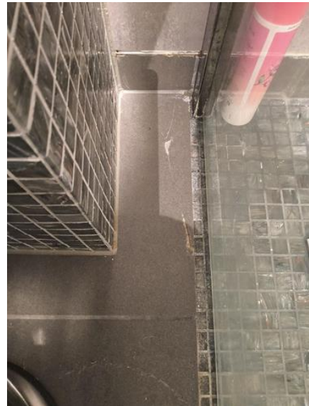
Overflater gulv - [Gulvflis ved dusjhjørne ]
