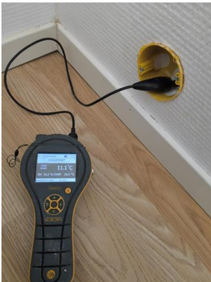
Fukt i tiliggende konstruksjoner - [Fuktmåling bad 2 etg ]
